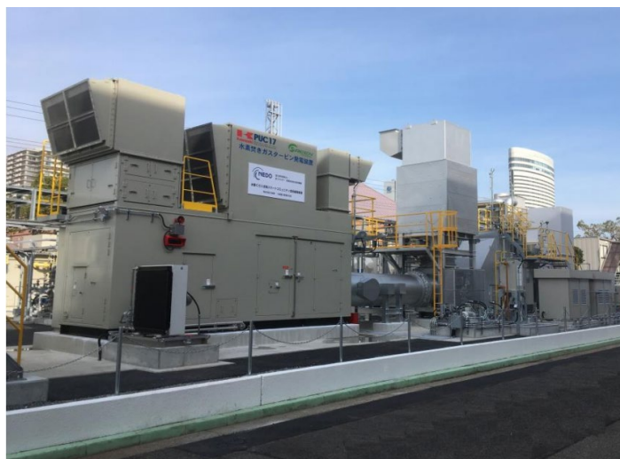
図1 今回実証に成功した、水素CGS実証プラント
